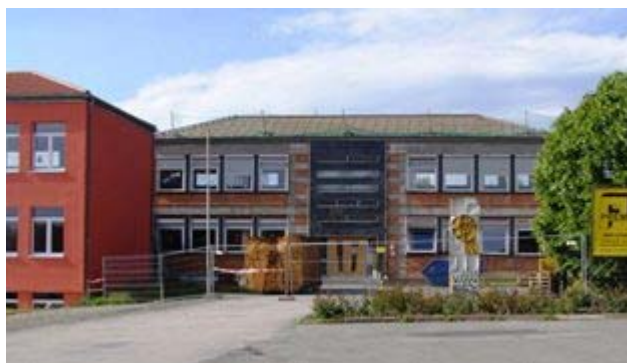
Der nicht mehr benötigte Schultrakt steht vor dem Abriss: die Dachziegel und die Fassadenplatten sind schon weg.
