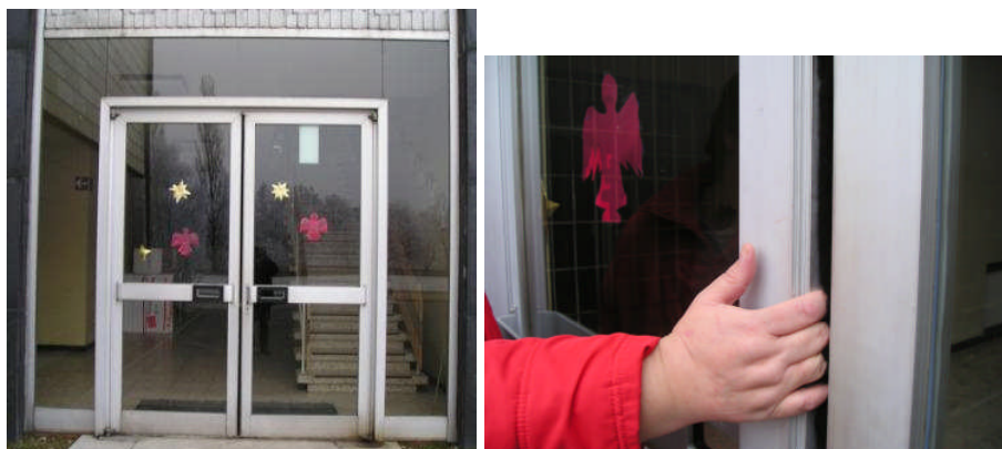
Luftige Seiteneingangstüre in der Schule: zwischen den Türflügeln passt fast eine Hand durch
