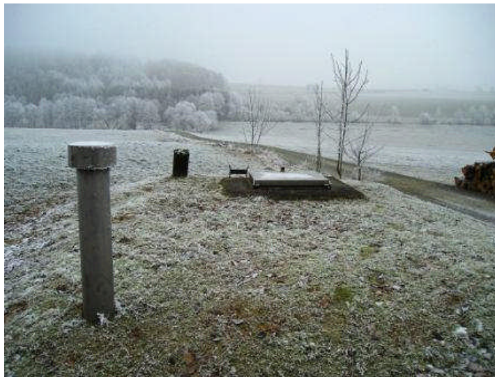
Übergabeschacht bei Woppenrieth
