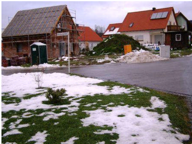
Baugebiet am Badeweiher – Baufirma leistet nun Schadensersatz
